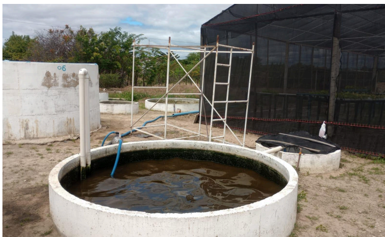
Imagem 34: Procedimento de limpeza do filtro decantador
