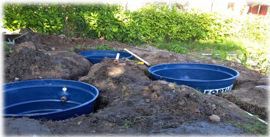
Figura 05. Caixas coletoras presas ao solo e interligadas por sistema de tubulação
