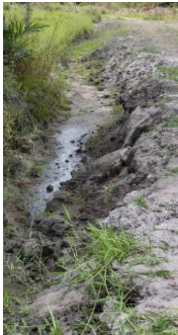
Imagem 10. Drenos em outubro de 2022, evidenciando a não objetividade da construção. Fonte: Autor.
