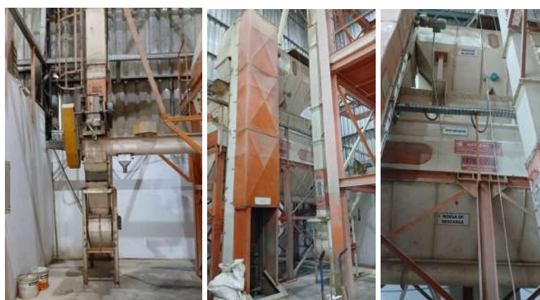
A. Elevador de expedição B. Elevador skip C. Misturador Figura 24 - Demais maquinários da Fábrica. Fonte: autora (2026)
