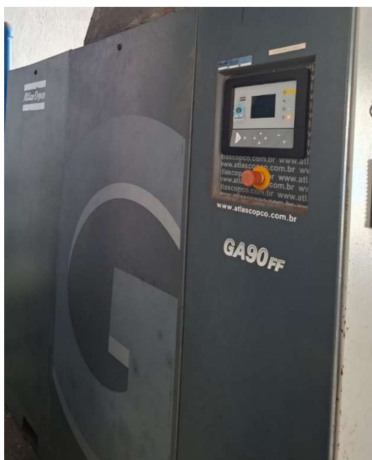
Figura 29 - Compressor Atlas Copco – VSD FF150 (CPP) da sala de compressores 2 – DPO.
