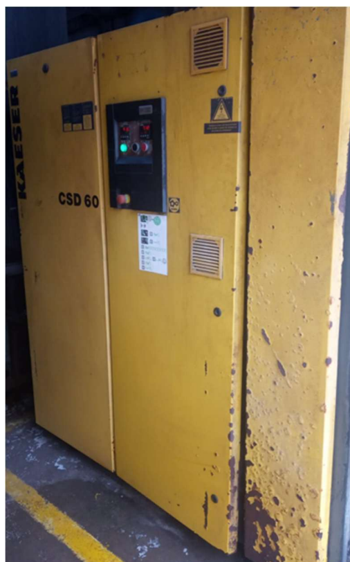
Figura 28 - Compressor obsoleto Kaeser CSD 60 (CPP6) da sala de compressores 2 – DPO.
