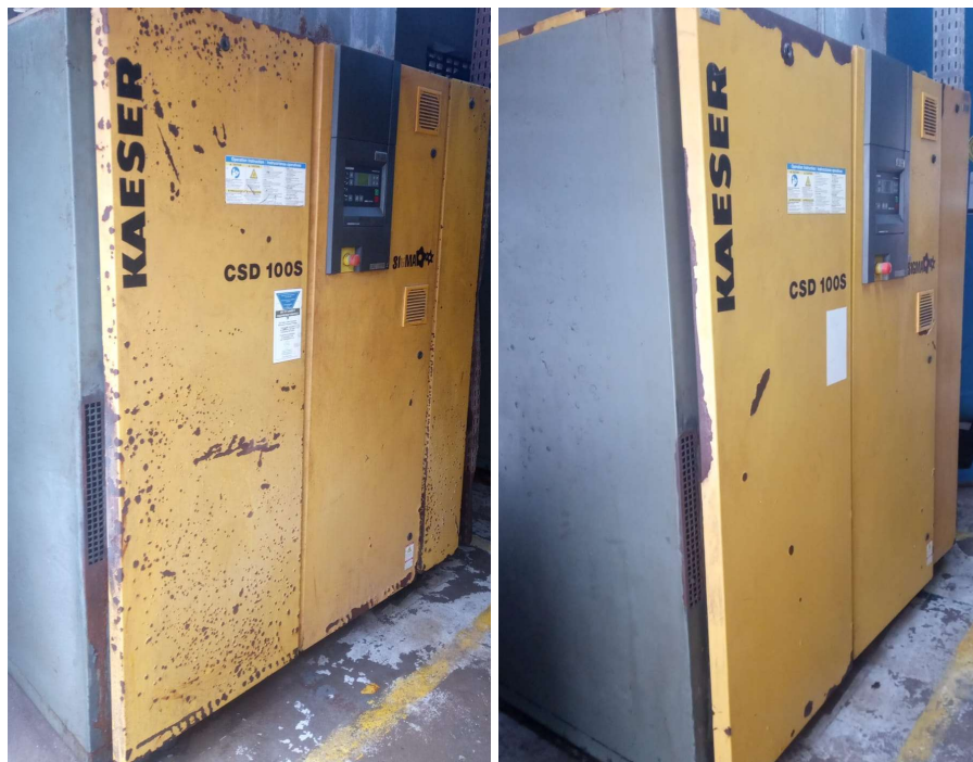
Figura 26 - Compressor Kaeser CSD 100S (CPP3). / Figura 27 - Compressor Kaeser 100S (CPP4).
