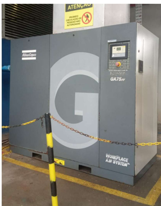
Figura 24 - Compressor Atlas Copco GA75 – 150FF (CPP1) da sala de compressores 1 – DPO.
