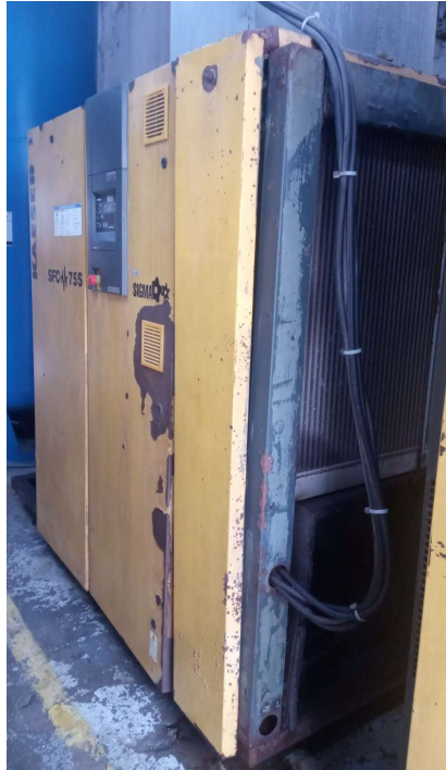
Figura 25 - Compressor Kaeser CSD 75S (CPP2) da sala de compressores 2 – DPO.
