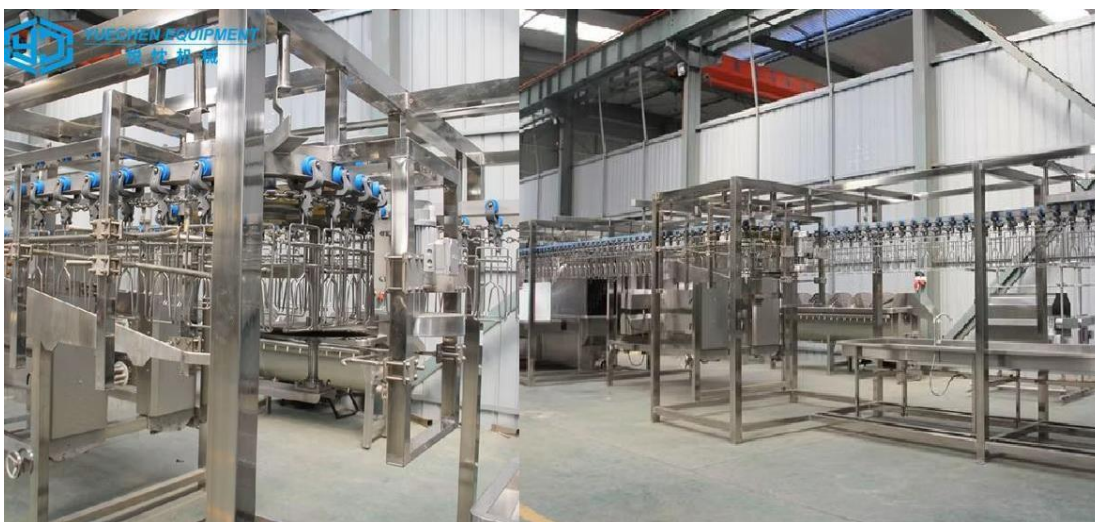
Figura 17: Equipamentos da linha de processamento industrial do abatedouro.
