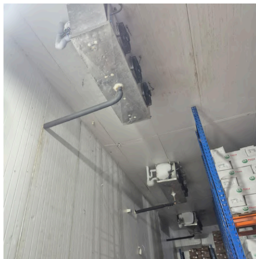
Figura 22. Evaporadores da câmara de congelados. Fonte: Arquivo pessoal.
