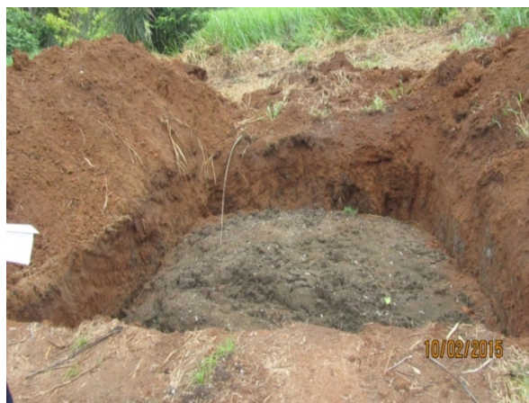
Figura 3. Disposição inadequada de resíduos sólidos da ETE no imóvel.
