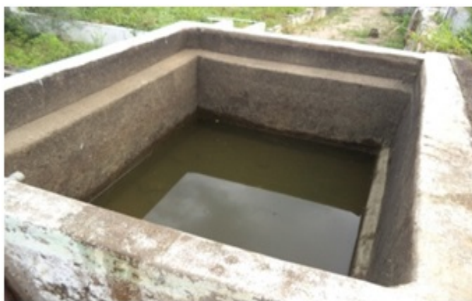
Figura 3. Caixa de água exposta no cemitério.
