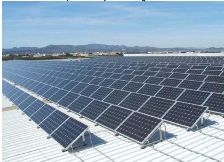
Figura 2. Painéis solares para utilização da energia solar como fonte de energia
