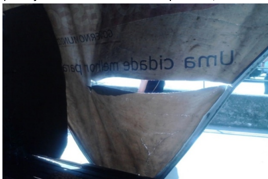
Figura 9. Lona de proteção a luz solar em estado precário, vista de dentro do Mercado.
