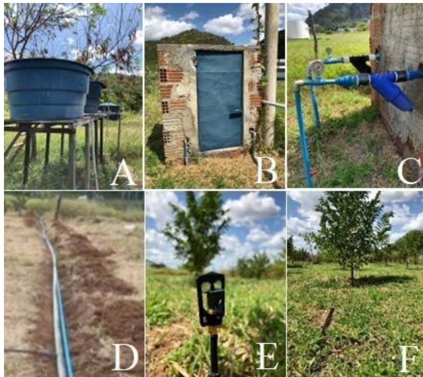
Figura 4 - Sistema de bombas e filtros para a distribuição da água (A,B,C); Distribuição das linhas principais para linhas laterais (D); Dimensionamento de microaspersores por planta (E); Dimensionamento de gotejadores por planta (F)
