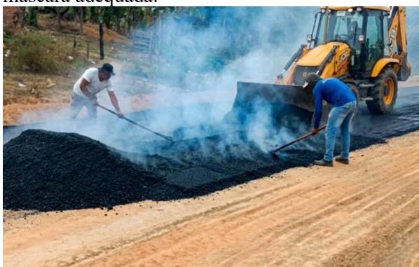
Figura 3 – Trabalhadores expostos a vapores sem máscara adequada.
