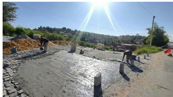
Figura 2 – Trabalhadores sob exposição solar sem EPI.
