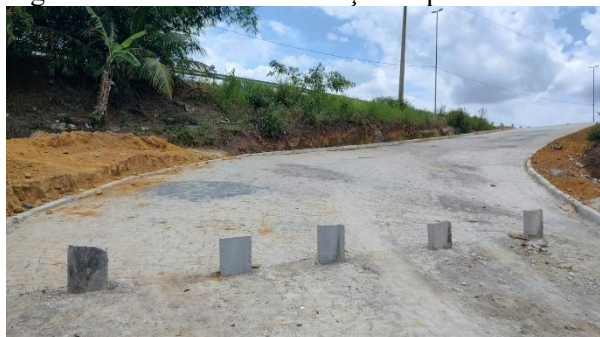
Figura 4 – Obra com sinalização improvisada
