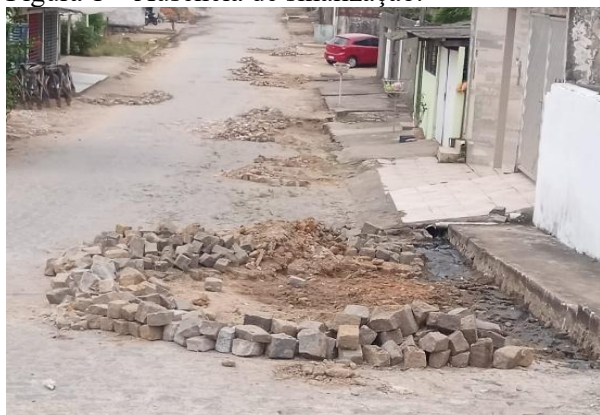
Figura 1 – Ausência de sinalização.
