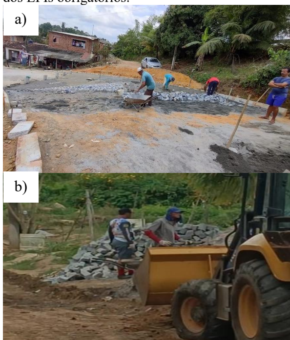
Figura 5 – Trabalhadores utilizando apenas parte dos EPIs obrigatórios.
