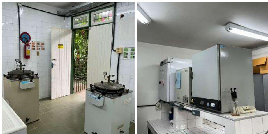
Figura 2 e 3 – Infraestrutura da sala de esterilização, evidenciando as autoclaves para esterilização e as estufas para secagem de material.
