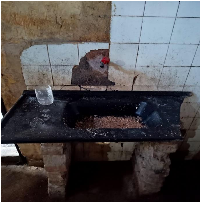
Figuras 42: Ausência de água corrente na torneira e pia inapropriada.
