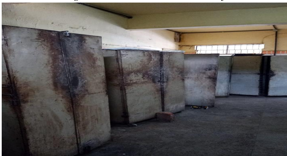
Figura 36: Estufas oxidados fechados com tijolos.
