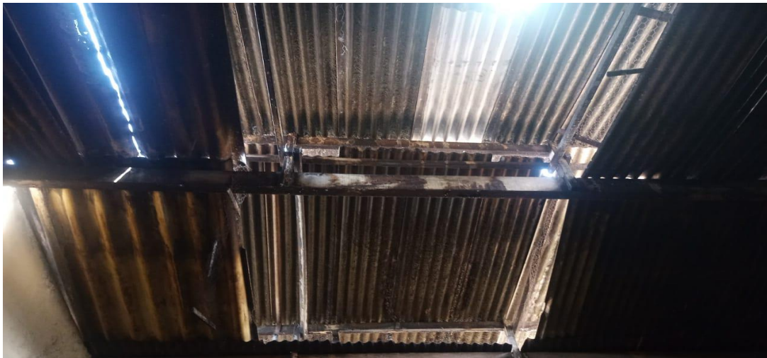
Figura 40: Infiltrações, rachaduras e mofos nas paredes e tetos.
