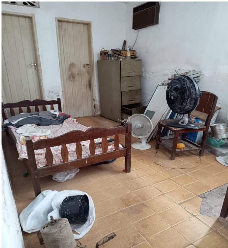
Figura 44: Desorganização do quarto de repouso dos funcionários em estado precário.
