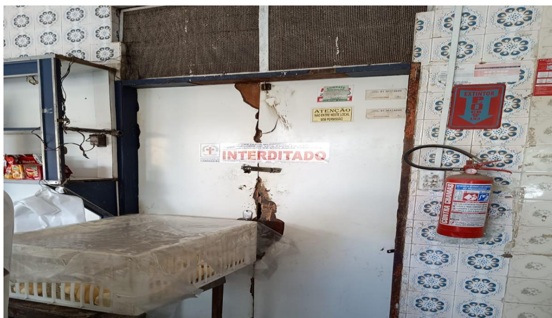
Figura 49: Presença de ninho de pombos na estrutura externa do ar-condicionado.
