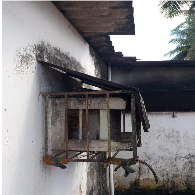
Figura 47: Presença de ninho de pombos na estrutura externa do ar-condicionado.
