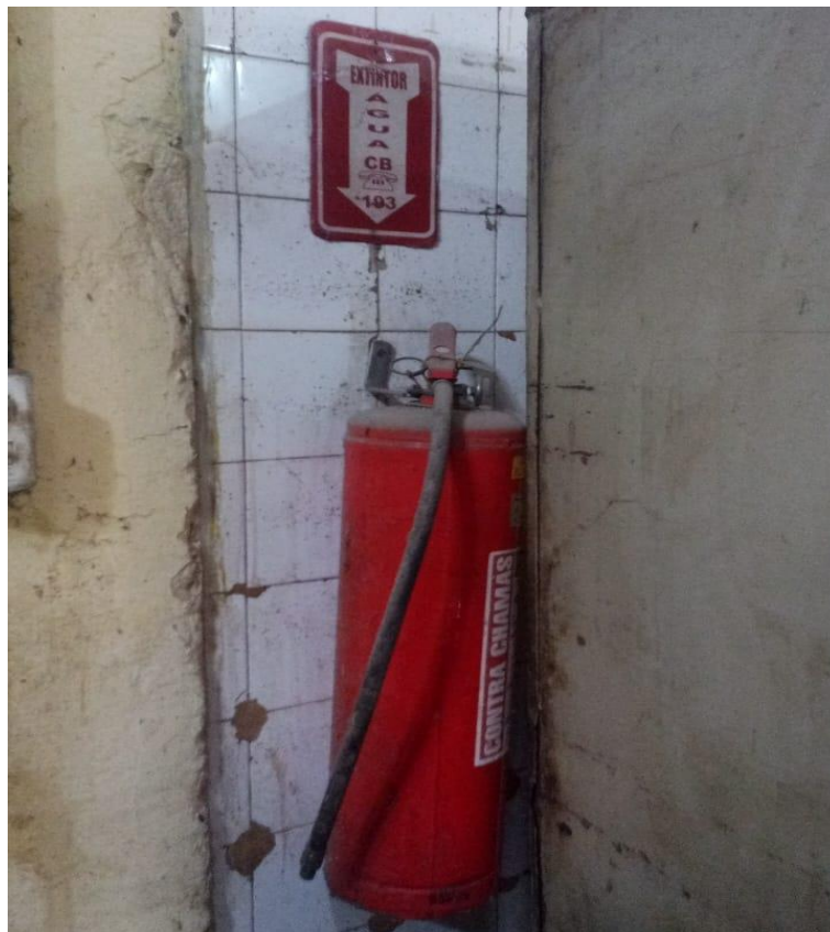
Figura 48: Extintor de incêndio com validade expirada há mais de sete anos.
