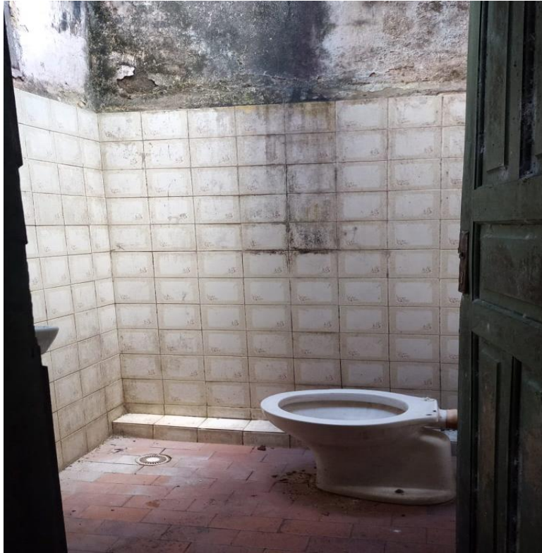
Figura 43: Banheiro dos funcionários e em péssimas condições de higiene e conservação.
