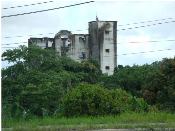
Figura 3 - Ruínas do prédio do Engenho Trapiche (localizada na entrada da comunidade, às margens da rodovia BR 101)
