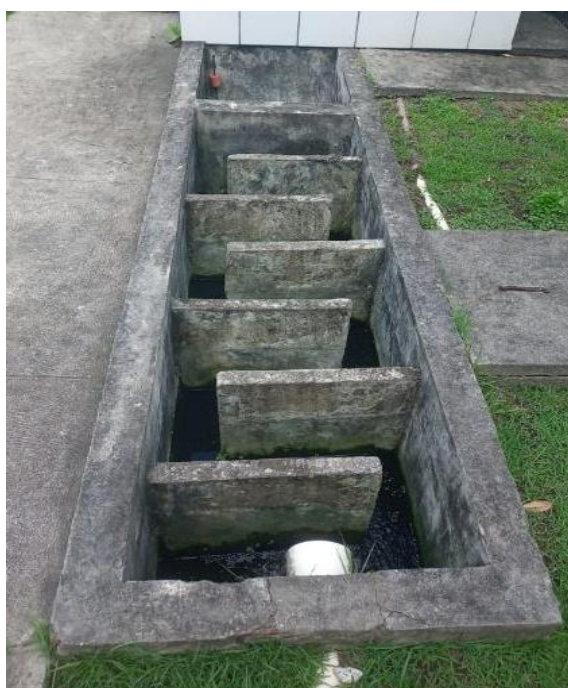
Figura 12 - Tanque de contato
