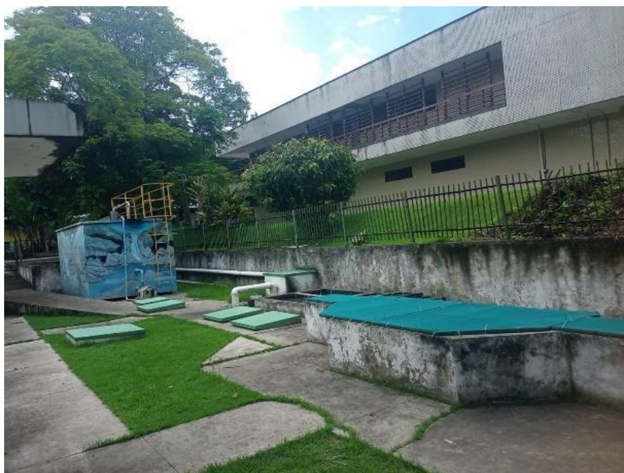
Figura 8 – Vista ETE tratamentos: primário, secundário e terciário
