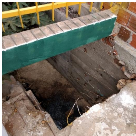
Figura 3. Lançamento de esgoto doméstico não tratado no solo.
