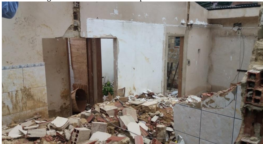
Figura 3. Residência destruída pelo deslizamento de terra.
