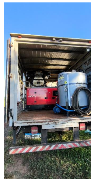
Figura 44. Gerador para recarga das baterias sobressalentes
