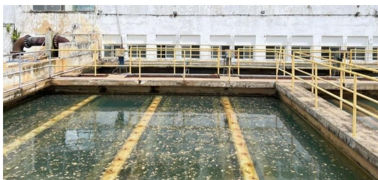
Figura 3 – Imagem de decantador da ETA de estudo
