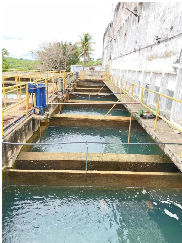
Figura 4 – Imagem dos filtros da ETA
