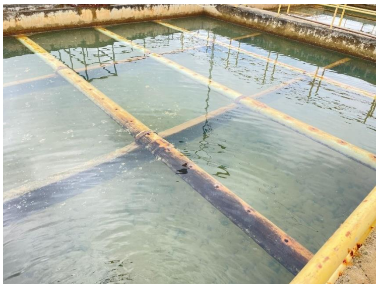
Figura 2 – Vista superior de um dos decantadores da ETA
