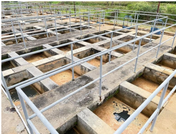
Figura 6 – Câmaras dos flocladores da ETA
