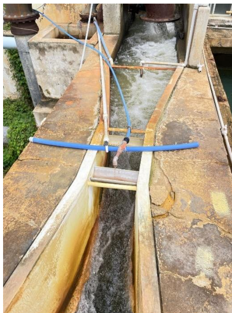
Figura 5 – Vista superior da calha Parshall da ETA de estudo
