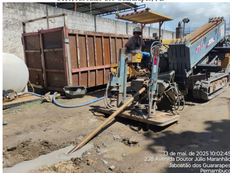
Figura 18 - Furo piloto para realização da travessia na linha férrea do metrô na Av. Dr. Julio Maranhão, Cajueiro Seco, Jaboatão dos Guararapes, PE
