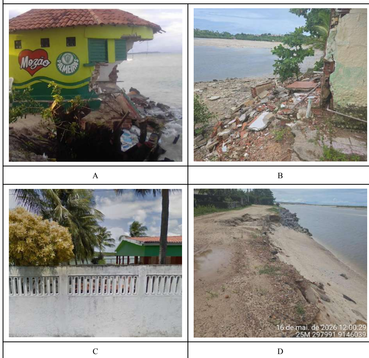
Figura 20- Em A, registro de estrutura comercial afetada pela erosão costeira na praia do Sossego, conforme Marco Zero Conteúdo (2022). Em B, registro de estrutura danificada em área próxima à linha de costa. Em C, imagem histórica do Google (2013). Em D, registro de campo dos autores (2026), evidenciando exposição de estruturas
