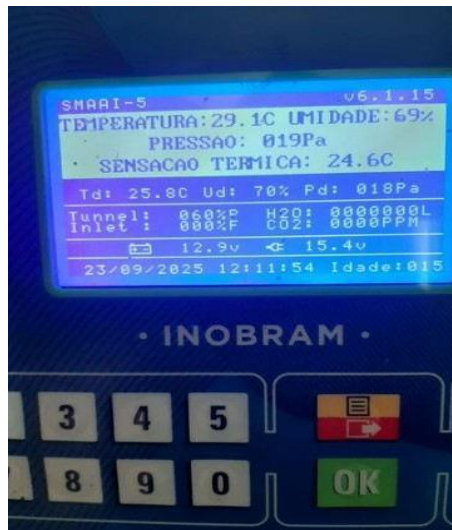
Figura 34 - Painel de controle de ambiência do aviário. Fonte: Arquivo pessoal, 2025. (Autorizado pela empresa)
