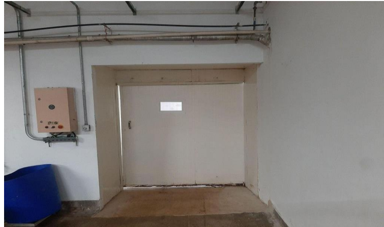
Figura 22 - Sala de pré-aquecimento. Fonte: Arquivo pessoal, 2025. (Autorizado pela empresa)
