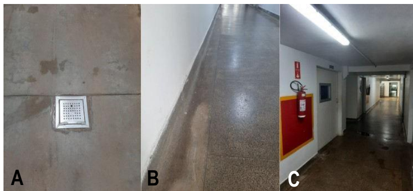
Figura 16 - (A) Ralo disposto no piso do corredor. (B) Piso, rodapé e parede dos corredores do incubatório. (C) Visão ampla dos corredores do incubatório. Fonte: Arquivo pessoal, 2025. (Autorizado pela empresa)
