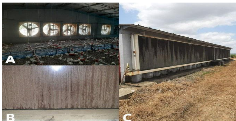
Figura 31 - (A) Visão interna do aviário, demonstrando os exaustores em uma de suas extremidades. (B e C) Pannel evaporativo (Cooling) na extremidade oposta aos exaustores do aviário. Fonte: Arquivo pessoal, 2025. (Autorizado pela empresa)
