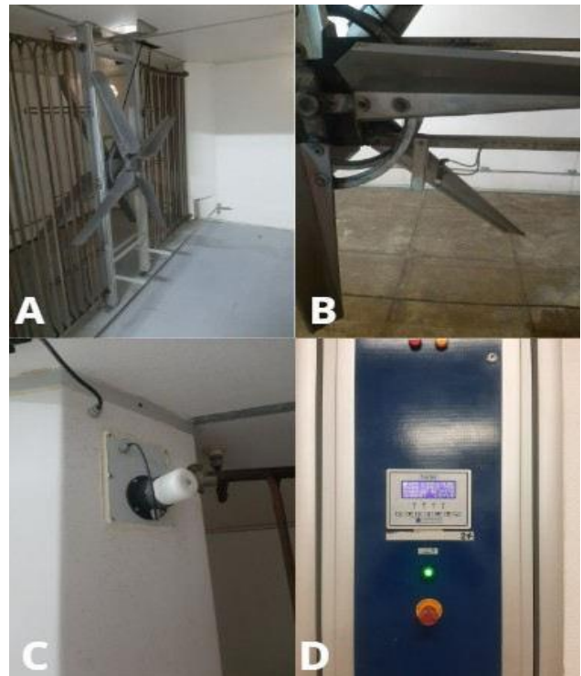
Figura 24 - (A) Sistema de controle de temperatura. (B) Aspensor de água para controle de umidade. (C) Sensor de parâmetros internos da máquina. (D) Painel de controle da máquina. Fonte: Arquivo pessoal, 2025. (Autorizado pela empresa)
