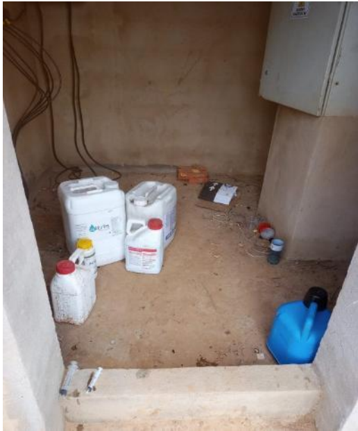
Figura 66 – Químicos na casa de bombas
