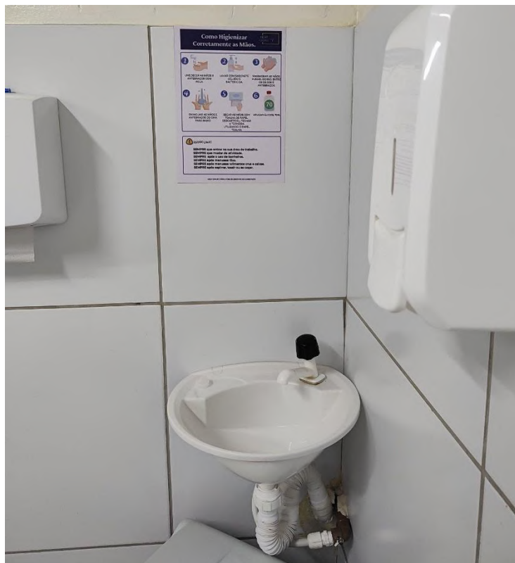
Figura 9 - Adequação realizada na sala de produção de alimentos.
