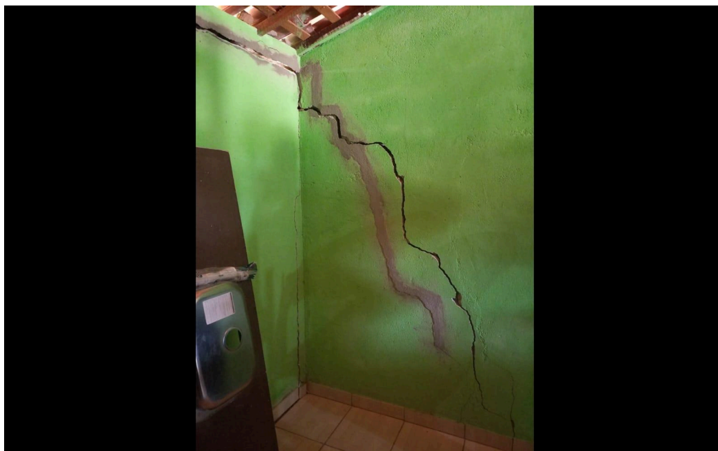
Figura 20 - Interior de uma casa rachada pelos impactos do Complexo Eólico no Agreste de Pernambuco.
