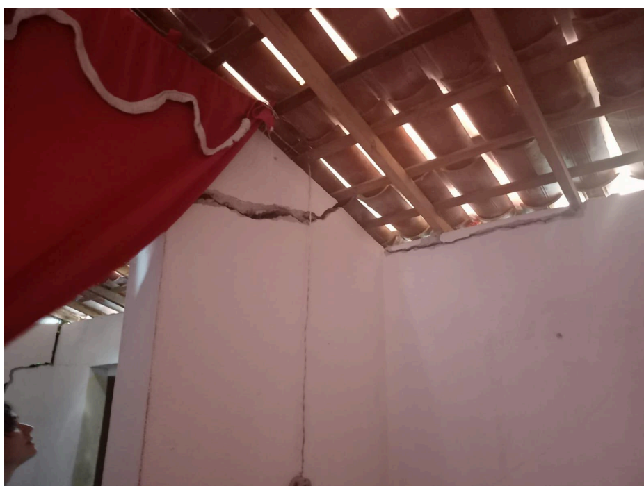
Figura 21 - Interior de uma casa rachada pelos impactos do Complexo Eólico no Agreste de Pernambuco.
