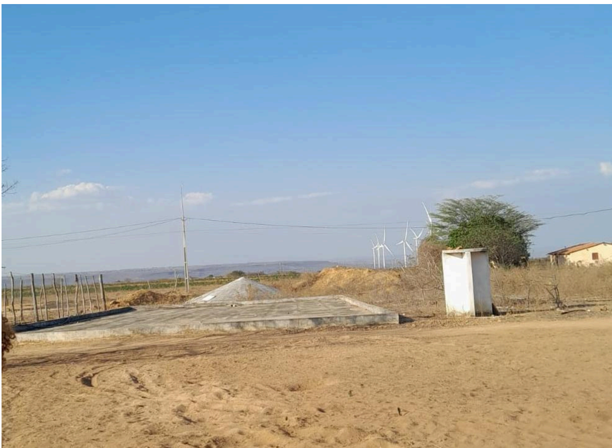
Figura 33 - Calçadão e cisterna construídos pela Casa dos Ventos na zona rural de Araripina.
