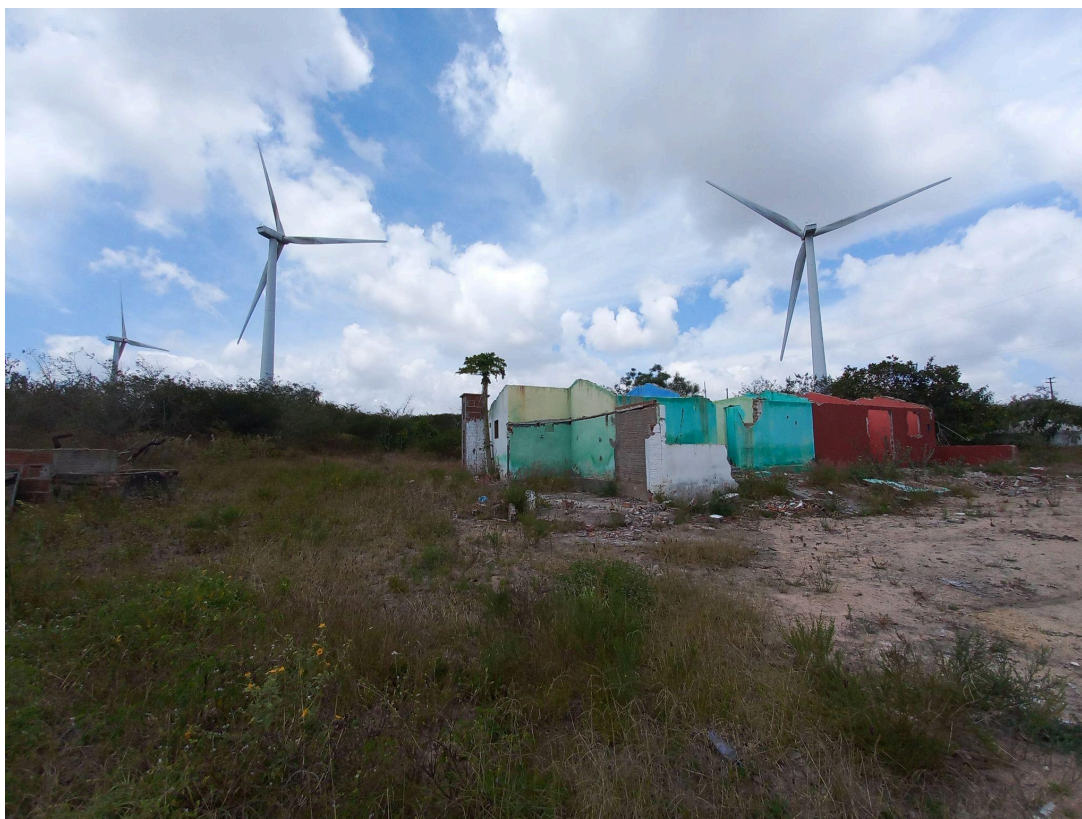
Figura 22 - Casa rachada pelos impactos do Complexo Eólico no Agreste de Pernambuco.
