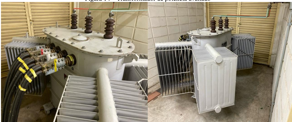
Figura 14 – Transformador de potência avaliado
