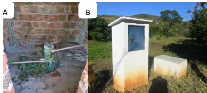
Figura 06 – Detalhes dos poços tubulares P2 (5a) e P5 (5b)
