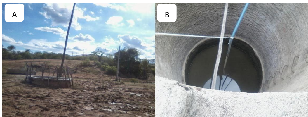
Figura 09 – Detalhe do espelho d'água do poço Amazonas A2
