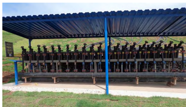
Figura 3. Estação de Regulação. Foto: CT-Candeias (2014).
