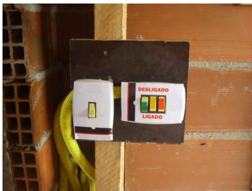
Figura 2. Interruptores do sistema automatizado da Obra B. Fonte: os autores (2014).
