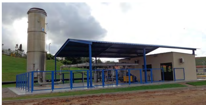
Figura 5. Unidade de Tratamento de Biogás vista posterior. Fonte: CT-Candeias (2014).
