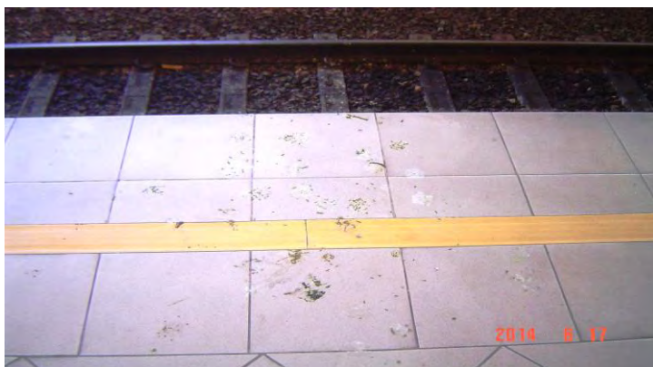
Figura 05. Danos às instalações (piso) causadas pelos excrementos de pombos. Fonte: Os Autores (2014).
