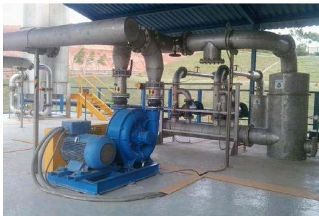
Figura 6. Pátio da central de aspiração e combustão. Fonte: os autores (2014).
