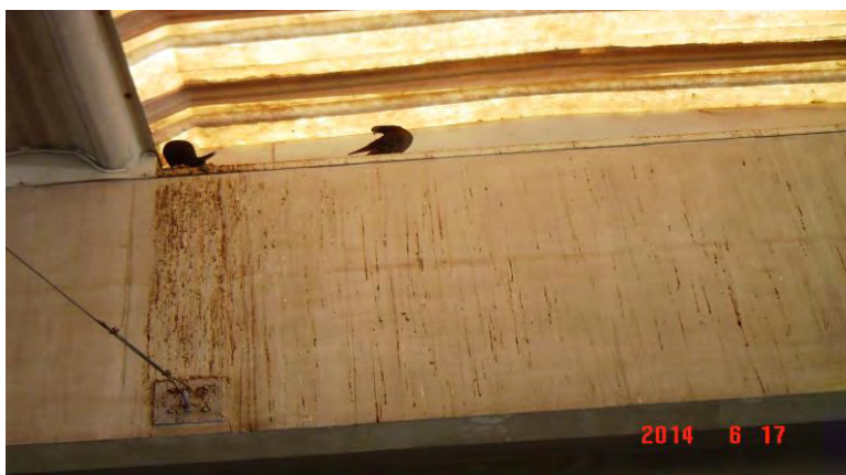
Figura 04. Danos às instalações (viga de concreto) causadas pelos excrementos de pombos. Fonte: Os Autores (2014).
