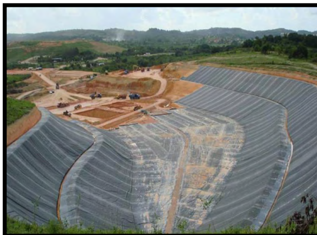
Figura 1. Base do Aterro Sanitário CTR candeias constituída por manta de PEAD. Fonte: CTR candeias, 2007.
