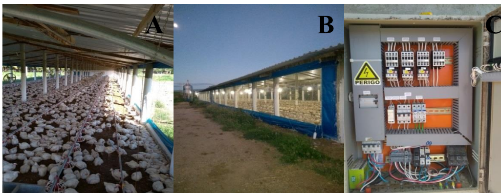
Figura 12. Sistema de iluminação: (A) Iluminação natural; (B) Iluminação artificial; (C) painel de controle com timers.
