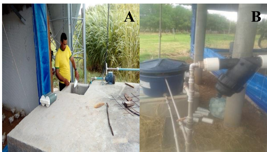
Figura 21. Tratamento da água: (A) Cloração da água; (B) Filtro de limpeza. Fonte: Arquivo pessoal, (2018.)
