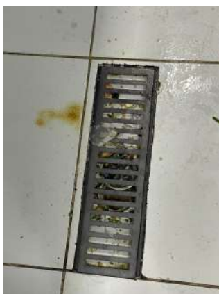
Figura 22- Dispositivo para escoamento (ralo) vedado inadequadamente.
