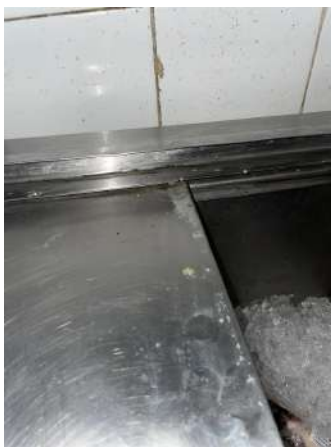
Figura 9- Sujidade em equipamento de armazenamento refrigerado.
