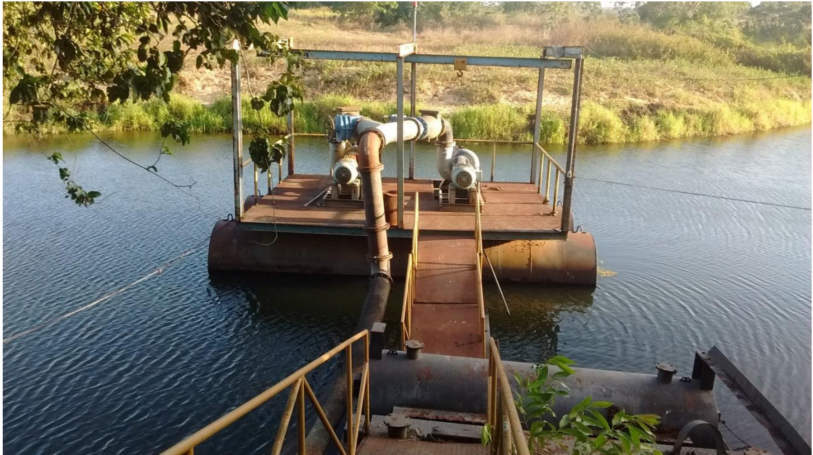
Figura 3. Bomba que capta toda água para o centro.
