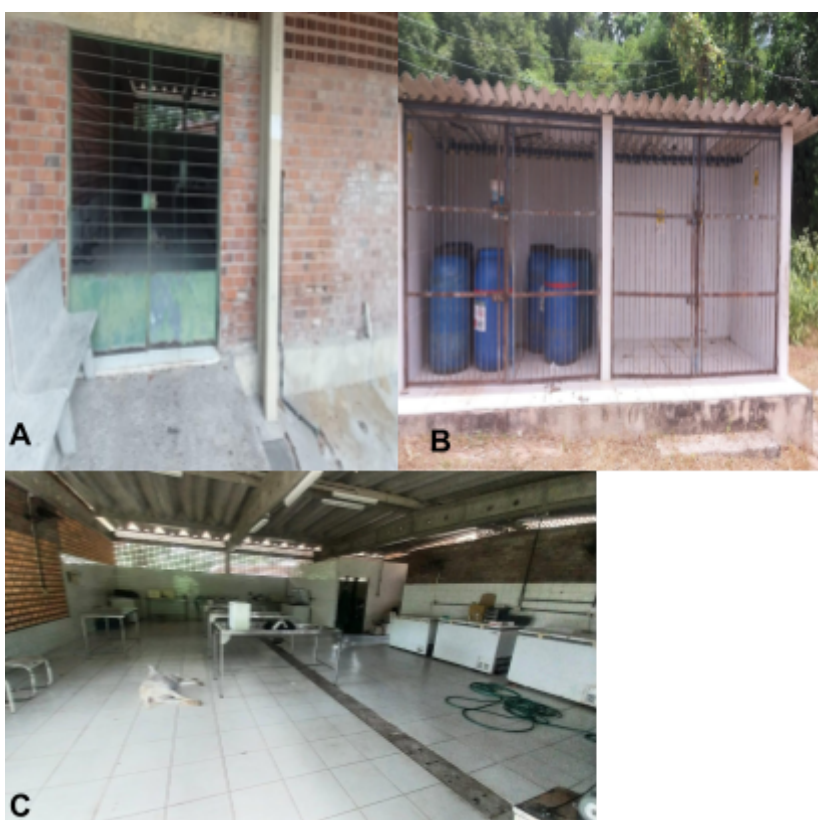
Figura 1: (A) Porta de acesso à sala de necropsia; (B) Área para acondicionamento dos recipientes de descarte contendo carcaças e partes biológicas; (C) Salão principal do pavilhão de necropsia.
