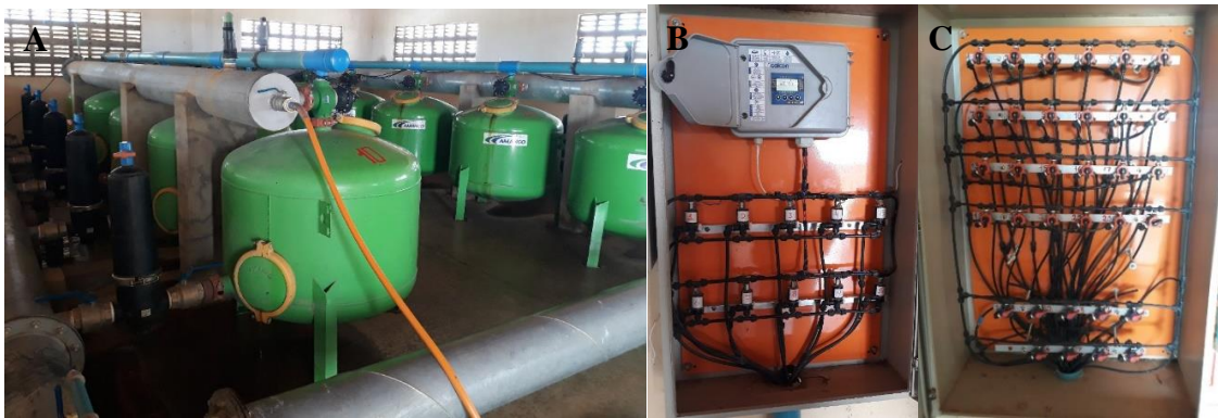
Figura 3: A – Filtros de areia e de disco; B – Painel de controle da retro lavagem dos filtros; C – Painel de controle de válvulas.
