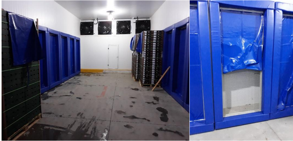
Figura 33: Túnel de resfriamento rápido através de circulação de ar forçada.
