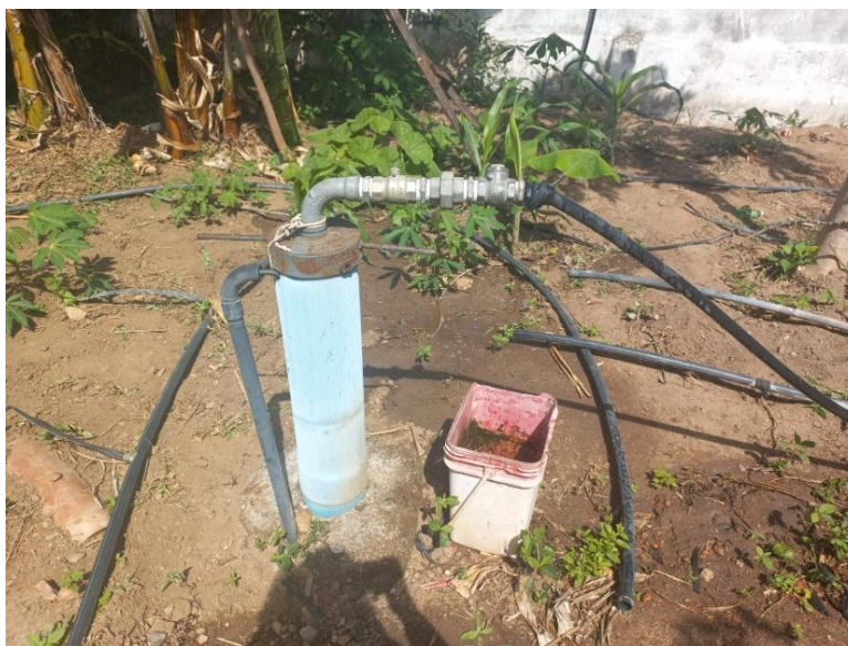
Figura 2: Poço Artesiano, IPA de Calumbi-PE.
