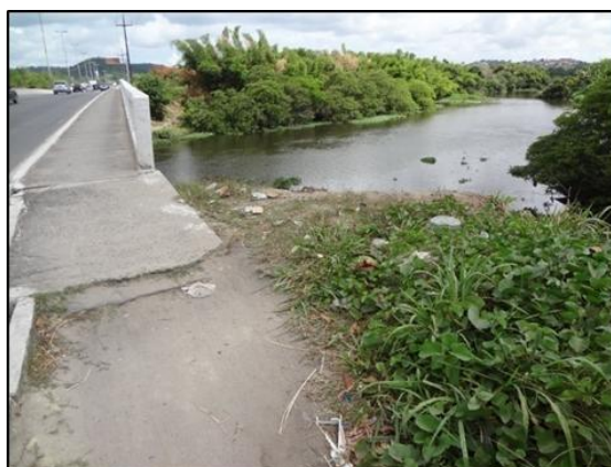
Figura 5. Risco de escorregamento e/ou erosão da margem do rio com a pista de rolamento.
