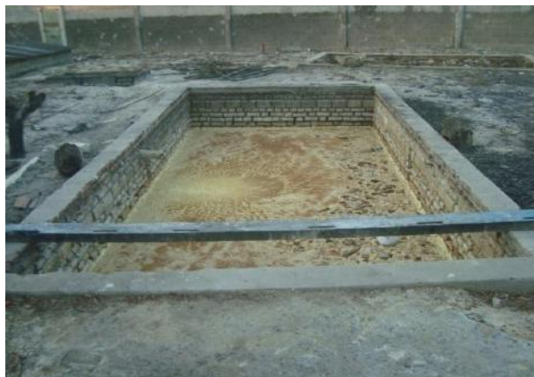
Figura 4 B - Tanque de armazenamento da manipueira em casa de farinha n°. 12 - zona urbana - Lajedo
