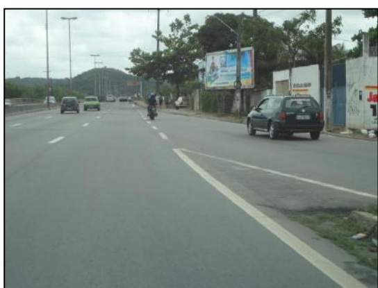
Figura 2. Desníveis e buracos sentido sul/norte.
