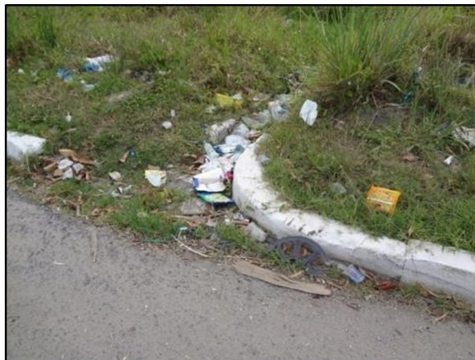
Figura 4. Precariedade do sistema de drenagem.
