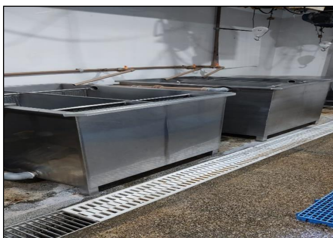
Figura 10. Caldeira da sala de cozimento.
