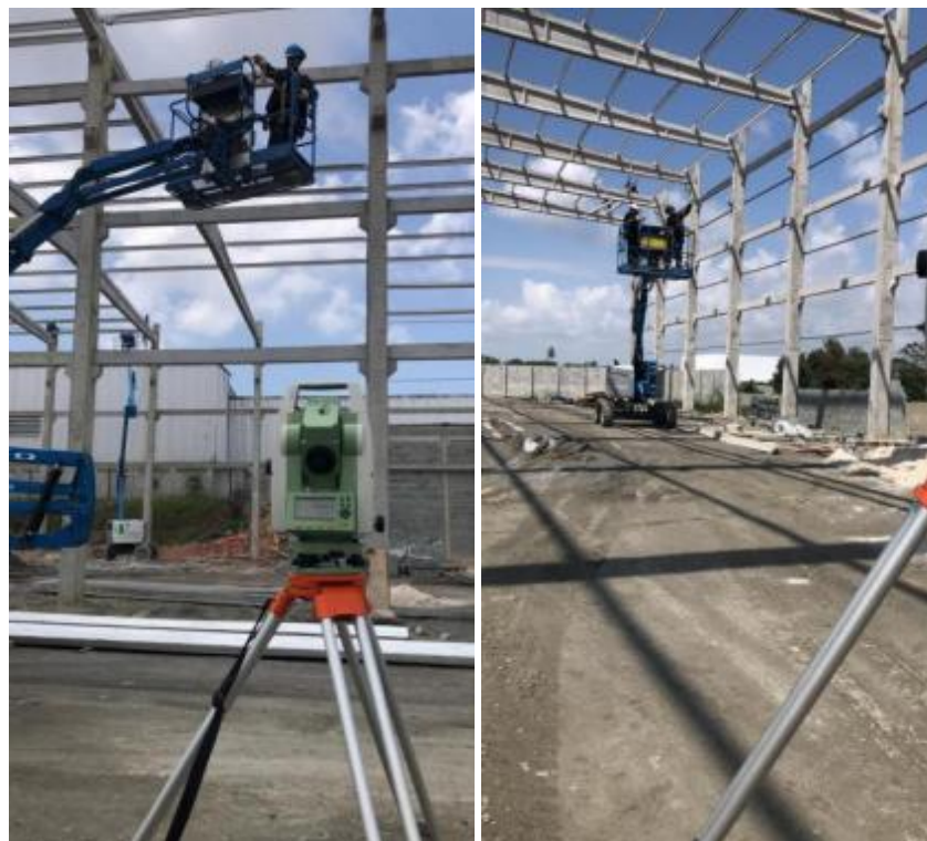
Fig. 2A e 2B - Execução de levantamento topográfico com estação total durante a montagem da estrutura metálica de um galpão industrial.
