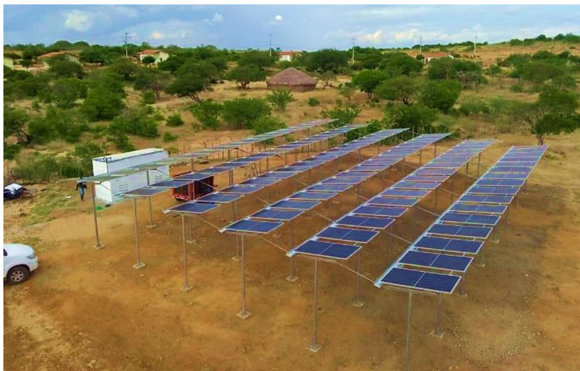
Figura 2 - Vista aérea dos painéis fotovoltaicos instalado na aldeia do serrote. Aldeia do Serrote - Itacuruba / PE, 2020.
