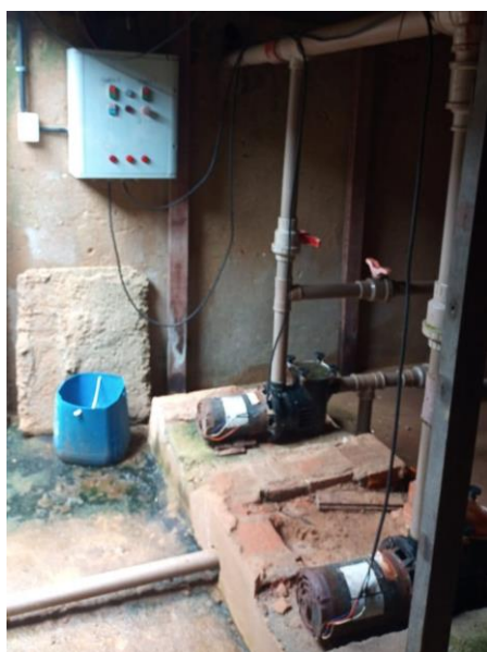
Figura 3 - Bombas centrífugas para captação de água do mar
