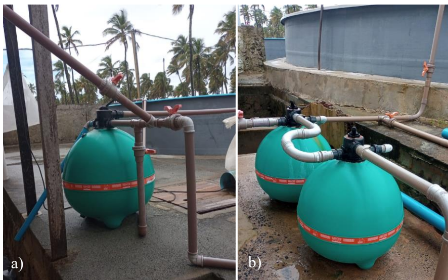
Figura 5 - Filtros de areia pressurizado – (a) Para os tanques de 60 T (b) Para os tanques de 275 T
