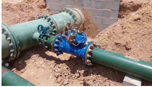
Figura 3 - Válvula antecipadora de ondas, quando em funcionamento, previne o golpe de aríete.
