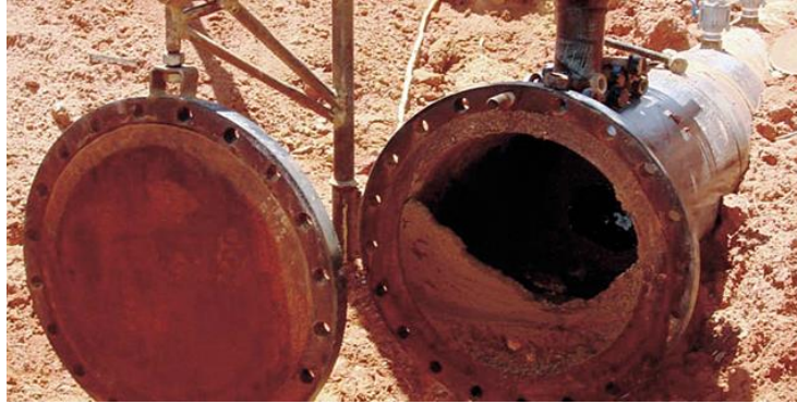
Figura 16 - Sujeira encrustada na tubulação.
