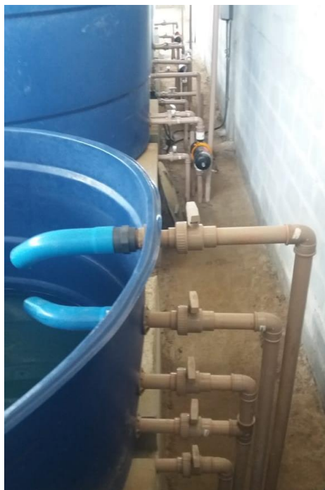
Figura 26 - Jogo de registros da caixa de diluição. De cima para baixo: alimentação de água, agitador, dupla sucção e dreno de limpeza.
