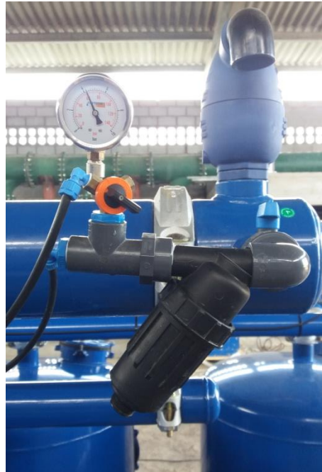
Figura 11 - Manômetro que controla o diferencial de pressão para acionar a retrolavagem.
