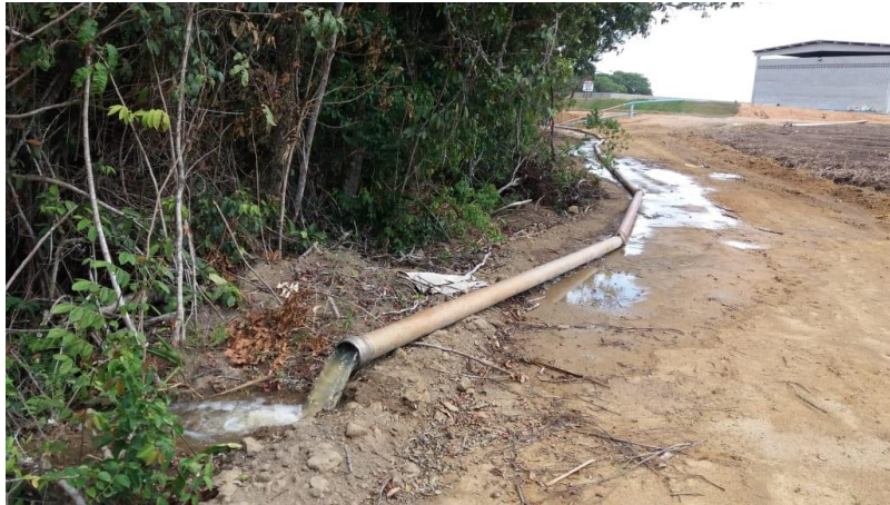
Figura 12 - Descarte inadequado da água de retrolavagem..
