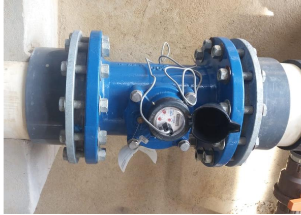
Figura 14 - hidrômetro: peça fundamental na verificação da vazão que sai do cabeçal de controle.
