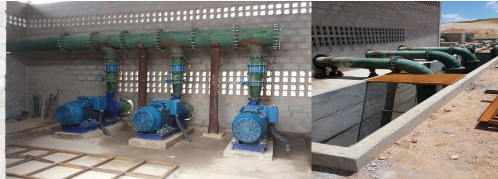
Figura 2 - Detalhes da estação de bombeamento (mostrando os motores seguidos por um registro e uma válvula de retenção) e sua sucção num poço de captação
