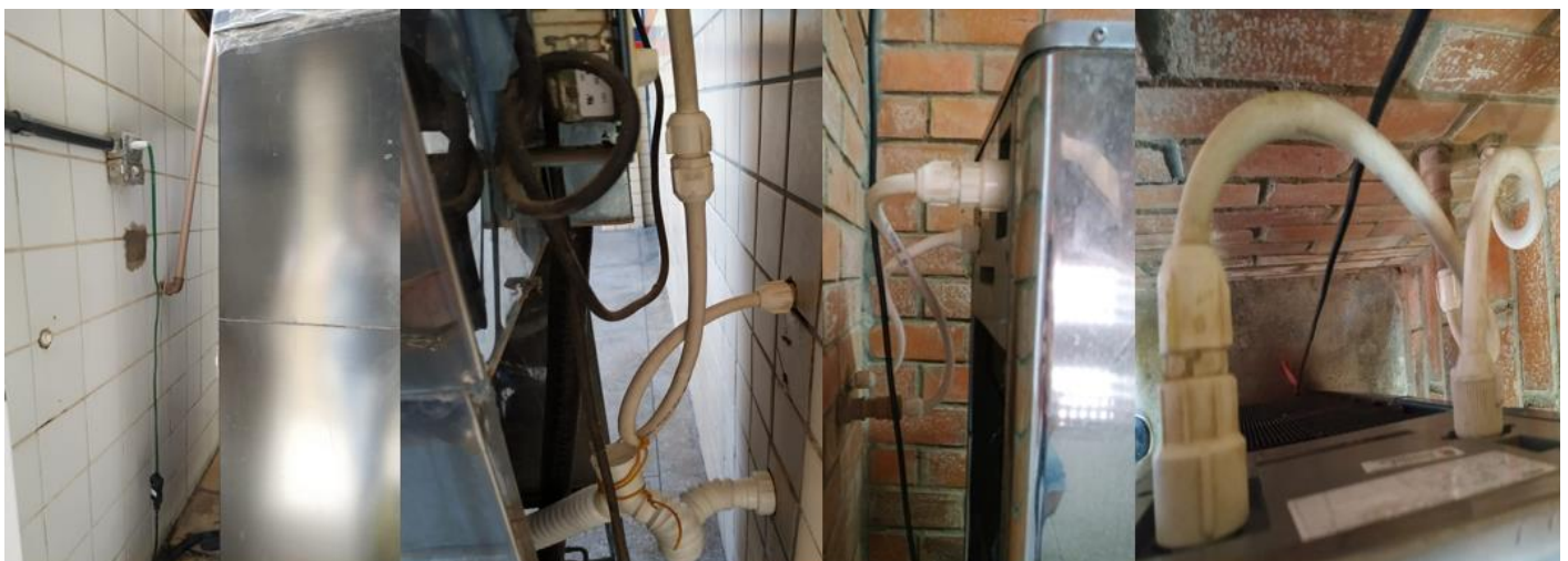
Figura 9. Canos responsáveis pela entrada e escoamento da água no bebedouro metálico. Fonte: Arquivo pessoal.
