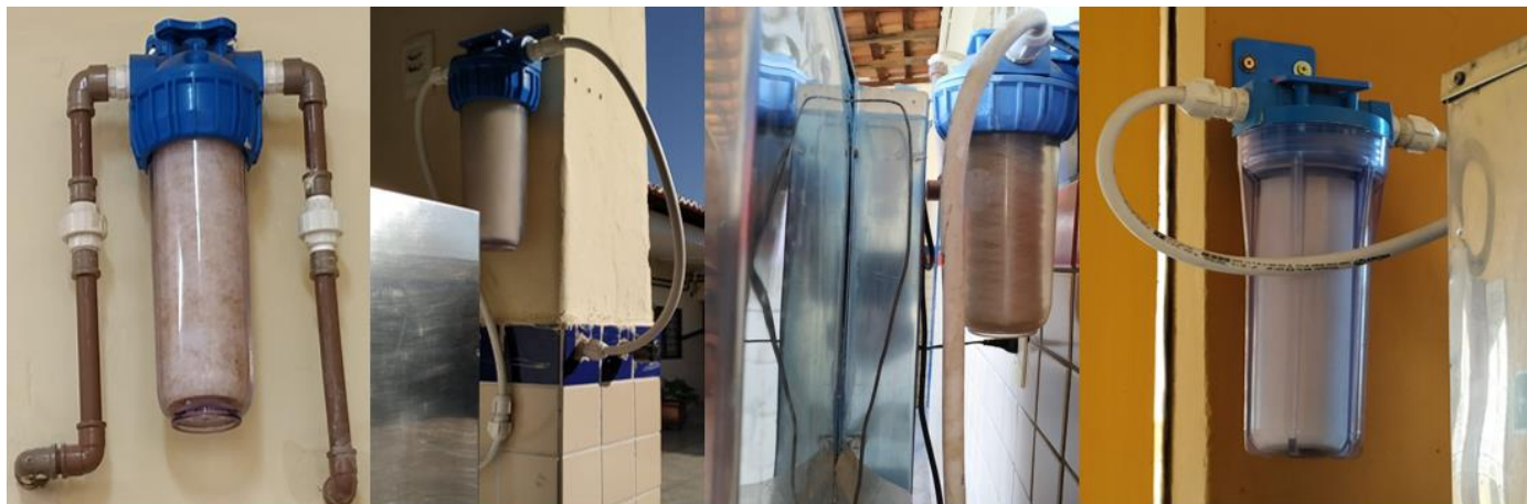
Figura 11. Filtros utilizados nos bebedouros metálicos. Fonte: Arquivo pessoal.
