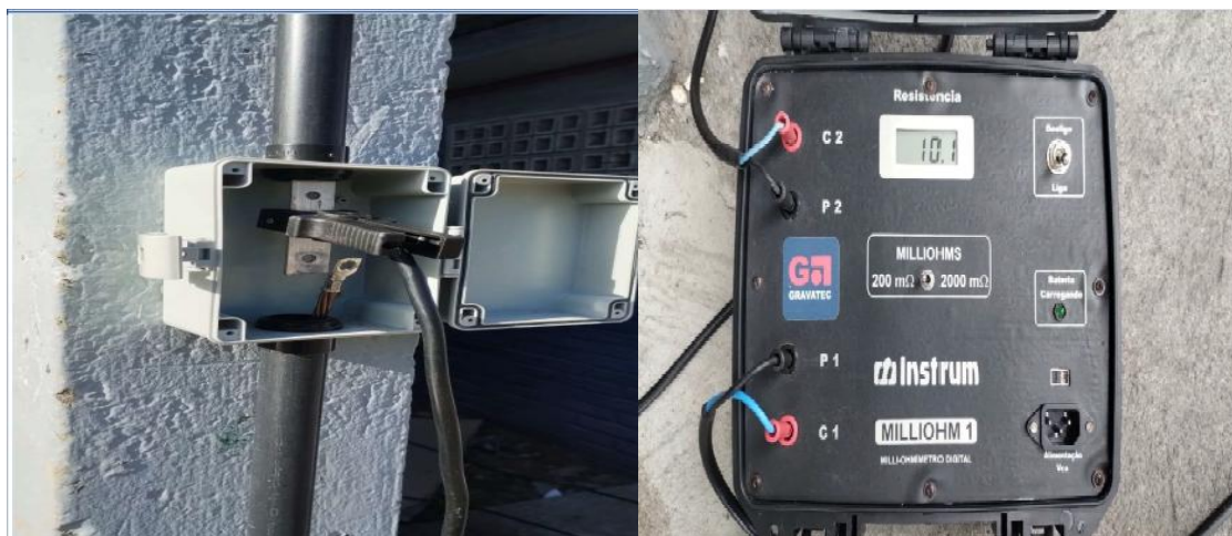
Figura 20 - Medição de continuidade e valor de resistência
